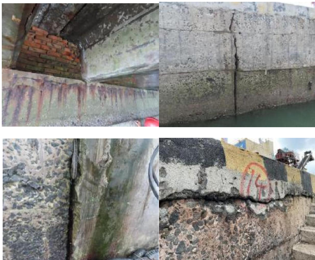
图 1.5-2 码头现状破损图
