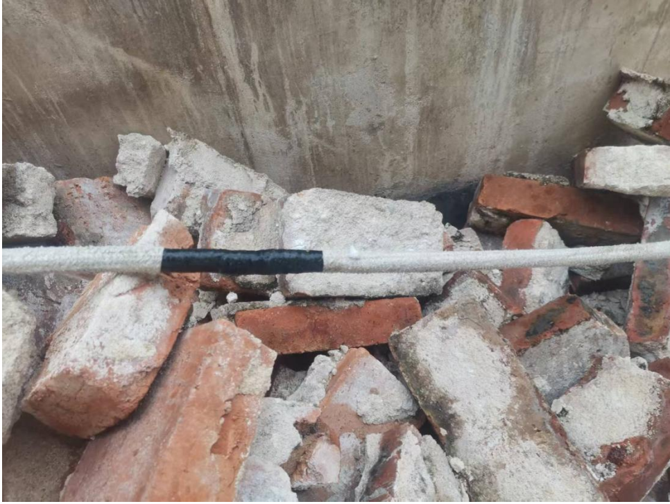
图 10 现场高空作业绳索磨损情况
