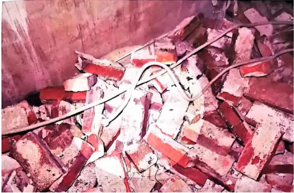
图 6 现场楼顶西北角发现绳索状况
