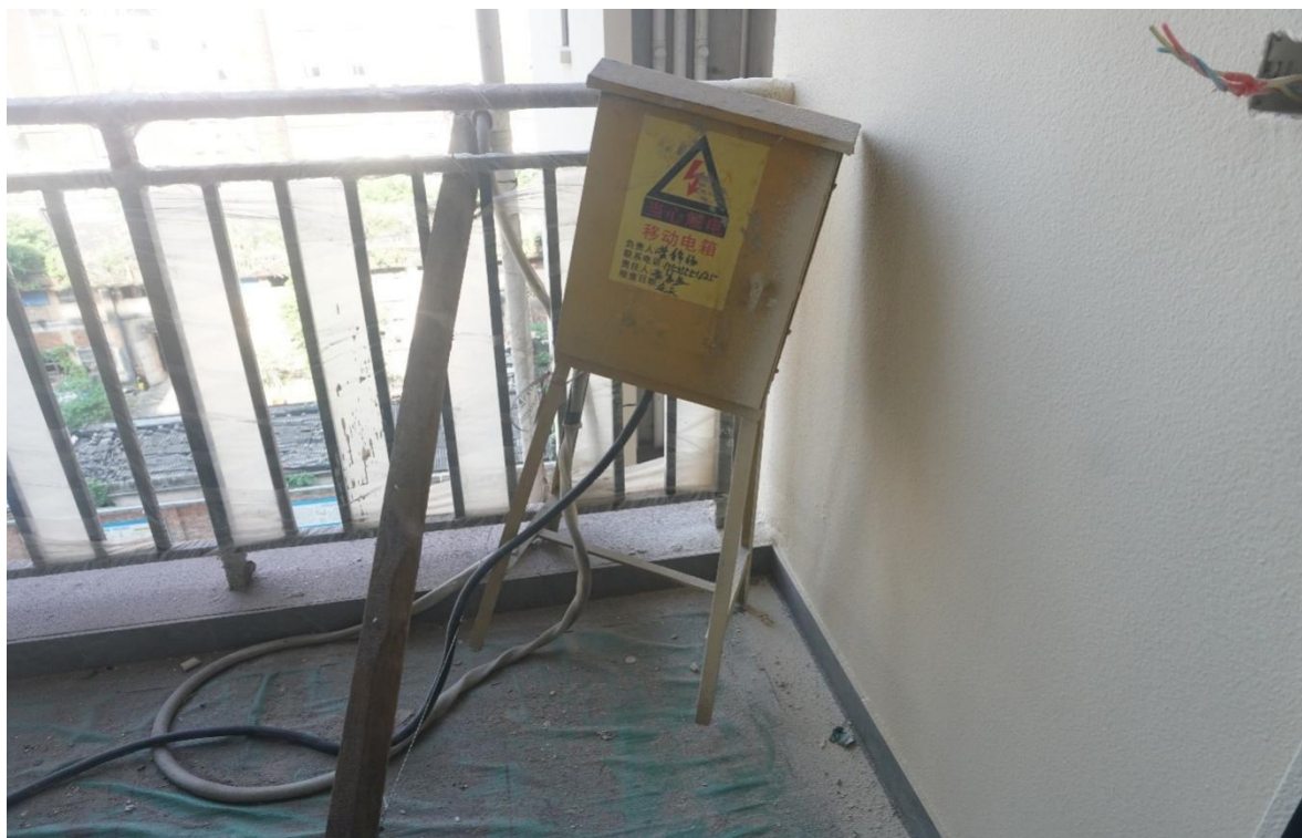
图 5 福文华府 2 号楼 8 楼阳台上的临时用电配电箱（黑色电缆为吊篮连接线）
