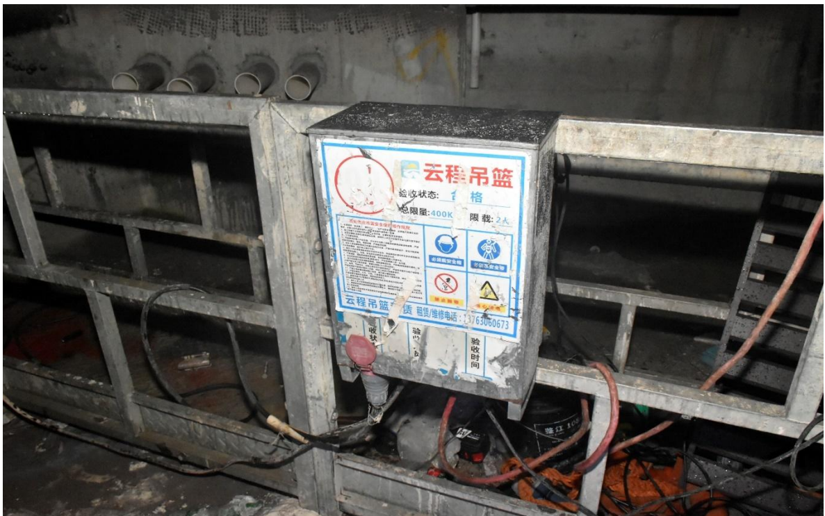
图 2 发生事故的电动吊篮
