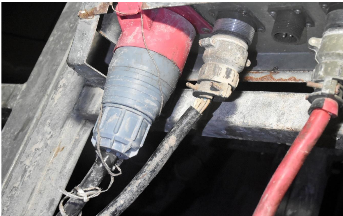
图 3 电动吊篮控制箱下方的电缆接口
