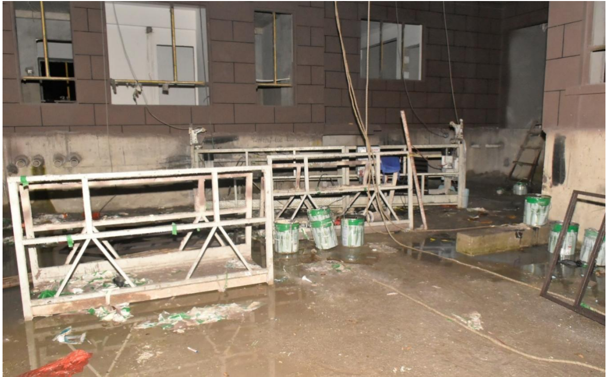
图 1 事故发生现场远景
